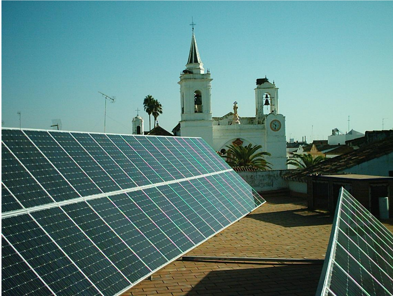
Instalación Fotovoltaica en Edificio Casa Consistorial
