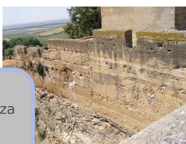
Murallas antes de la rehabilitación.
